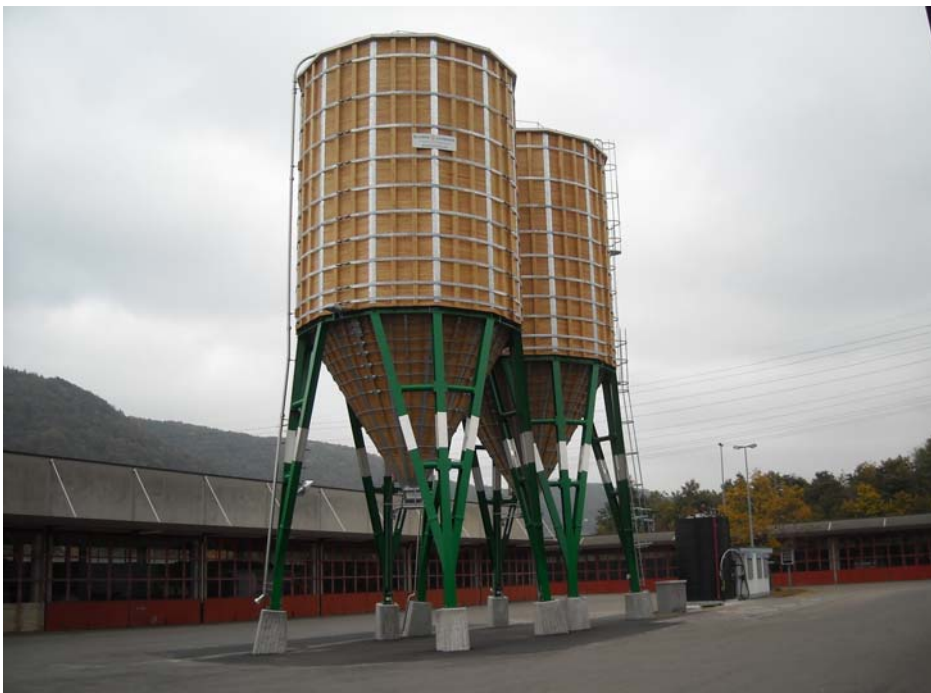
Neue Salzsilos im Werkhof Frick (2010) Lager Auftaumittel für effizienten Winterdienst
